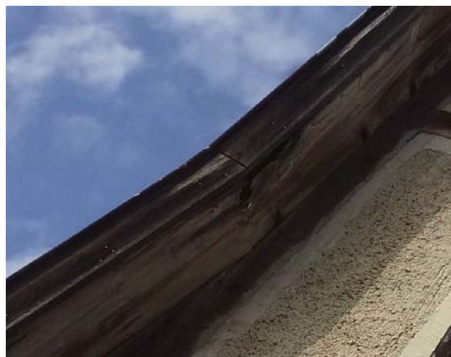
Abb. 14: Lücken in der Dachverwahrung.
