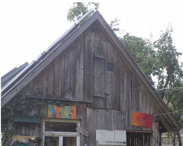
Abb. 13: Spalten zwischen den Latten.
