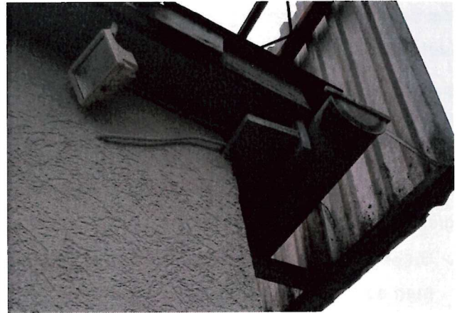
Abb. 20: Holzabsatz hinter der Dachrinne an der Ostseite von Gebäude Nr. 3 mit Nistplatzpotenzial für Nischenbrüter
