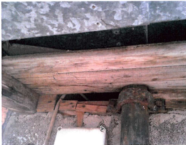
Abb. 21: Holzabsatz im Dachbereich von Gebäude Nr. 1 (Nordseite) mit Nistplatzpotenzial für Nischenbrüter
